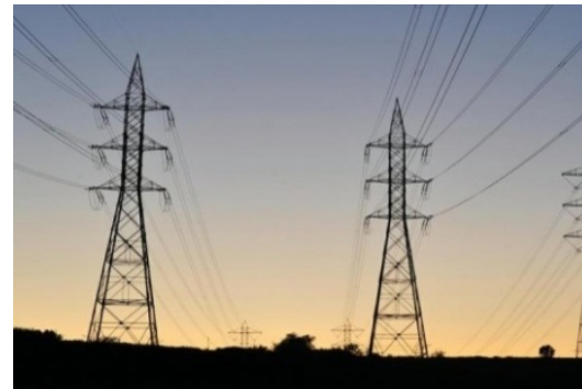
ZUGANG ZU ELEKTRIZITÄT
