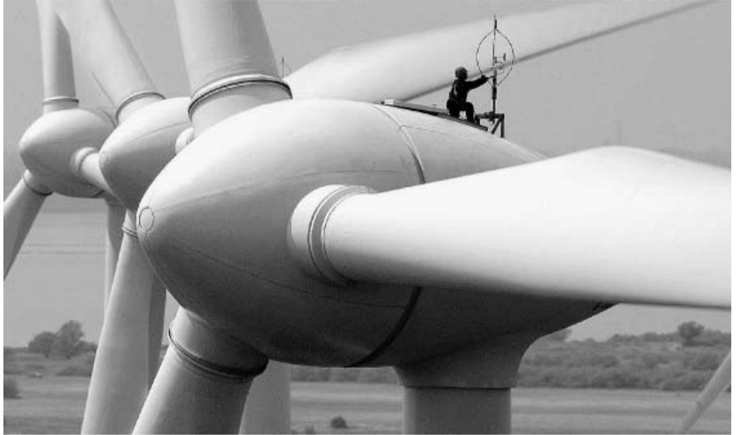
Wirtschaftlich gesehen profitieren die Windkraftbauer vom Klimawandel. So wird der Umweltbranche für die nächsten Jahre eine größere Bedeutung als etwa der Automobilindustrie prophezeit. FOTO: DPA
