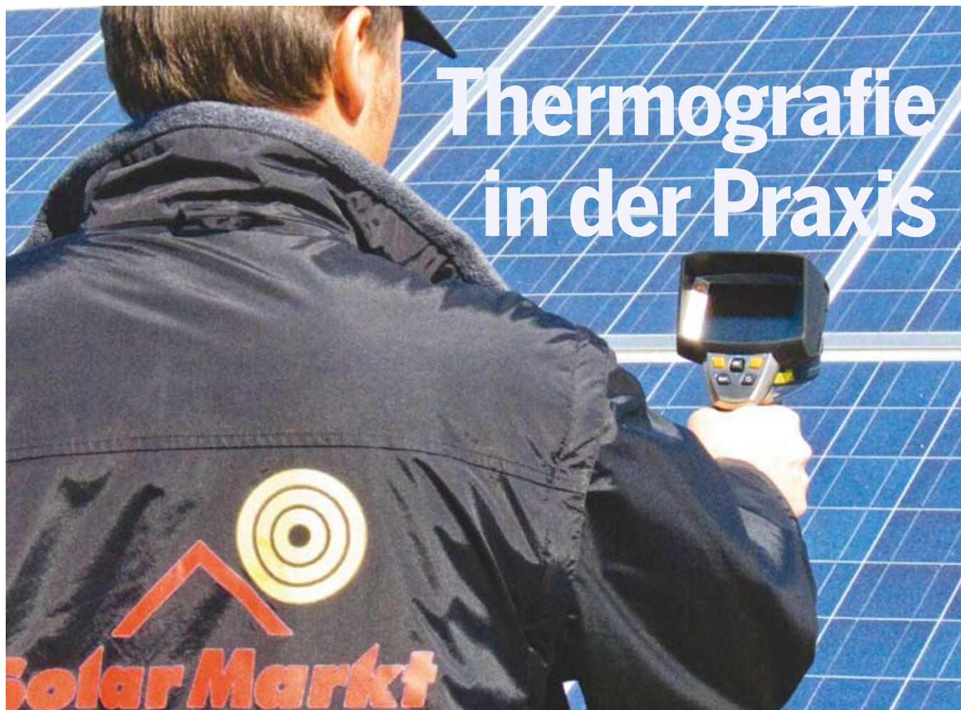
Abscannen mit einer Wärmebildkamera als Qualitätscheck im Solarkraftwerk
