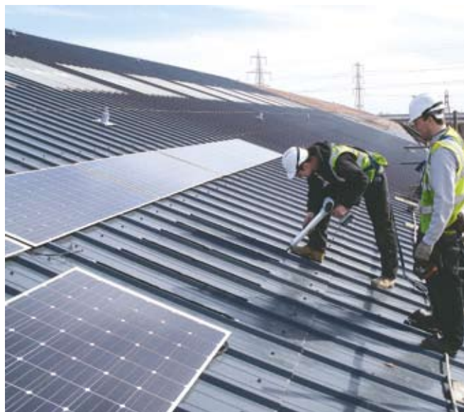
Das Solardach von Solon und Tata Steel ist vor allem bei der Neueindeckung von Industriedächern eine Option.
