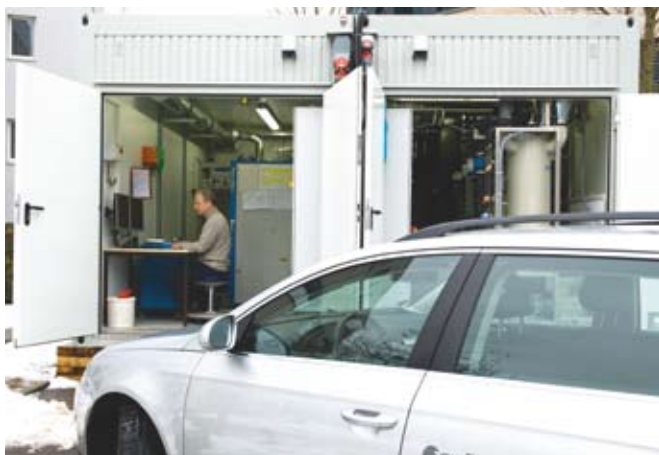
Die Solarfuel-Demonstrationsanlage am ZSW in Stuttgart. Foto: ZSW
