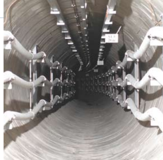
Kabeltunnel der 380-kV-Diagonale 24 m unter Berlin-Friedrichshain, Blick Richtung Osten. Links und rechts ist jeweils für jede der drei Phasen ein Kunststoffkabel angebracht. Oben ist die Schiene der Hängebahn zu sehen, mit denen die Techniker den 5,2 km langen Tunnel befahren können.
